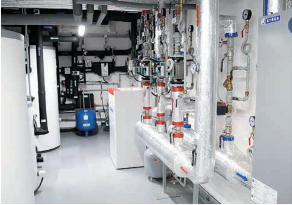
Kotłownia w budynku pasywnym Urzędu Miejskiego.
